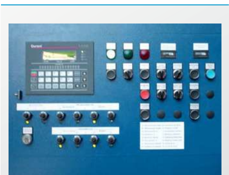
Electric cabinet. Schaltschrank.
